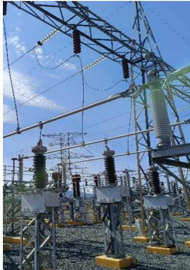
Ilustración 26: Transformador de Potencial para Exteriores, con relación (115000/\sqrt{3})/(120 \text{ VAC}) , en subestación de C.H. 15 de Septiembre, para medición comercial y sincronización de Unidad 1.
