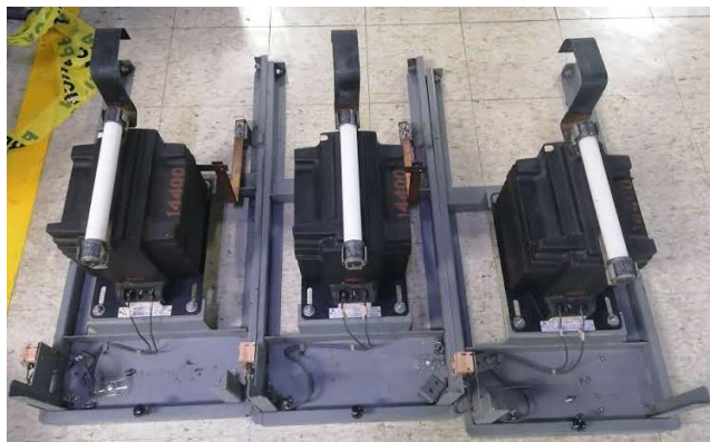
Ilustración 27: Transformador de Potencial para Interiores, Relación de 14400:120 VAC, para medición, Sincronización y Protección de Unidades Generadoras de C.H. 15 de Septiembre.
