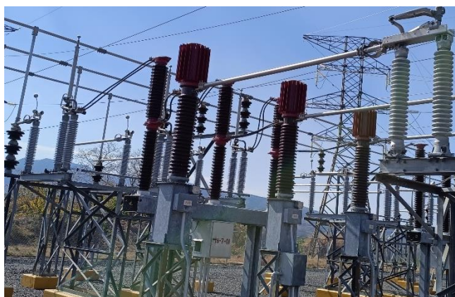
Ilustración 30: Transformador de Corriente en Patio de Subestación de C.H. 15 de Septiembre, con relación 1200:5 (utilizado en tap 600:5), para medición comercial y protección.
