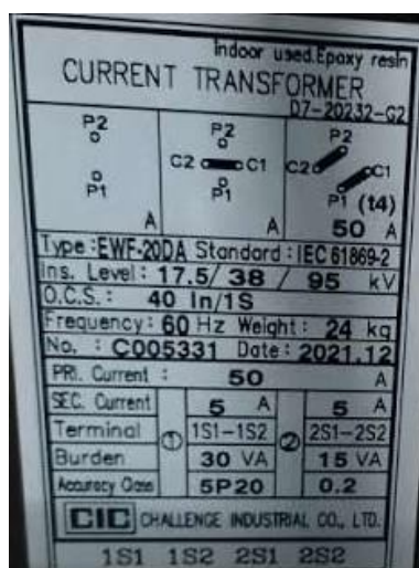
Ilustración 31: Placa de Característica de Transformador de Instrumento Mixto (corriente) de Servicio propio de C.H. 15 de Septiembre.
