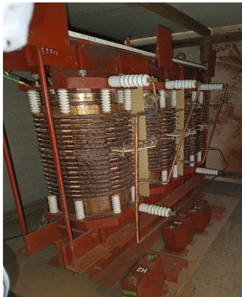
Ilustración 101: Transformador Trifásico de Potencia que será sometido a pruebas de campo de relación de transformación. Ubicado en Central 15 de Septiembre.
