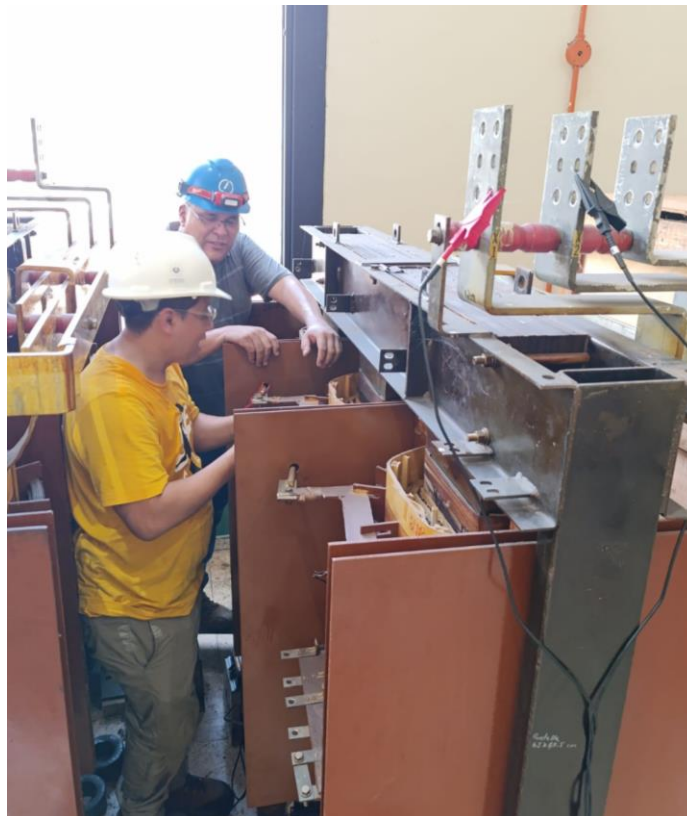
Ilustración 104: Estudiantes Realizando Pruebas en Transformador de Central Hidroeléctrica 15 de Septiembre.
