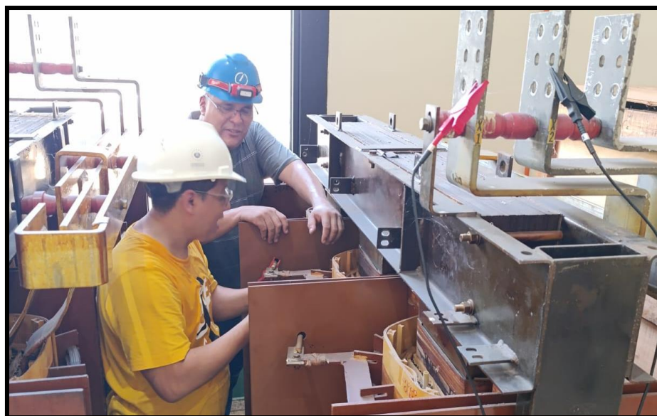
Ilustración 64: Alumnos Realizando Pruebas en Transformador con TTR/DTR 8510.
