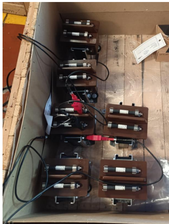
Ilustración 106: Grupo de Transformadores TC Recién Ingresados a los Cuales se les Realizo la Prueba TC.
