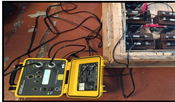
Ilustración 69: Pruebas a Transformadores TC con Equipo TTR/DTR AEMC 8510.
