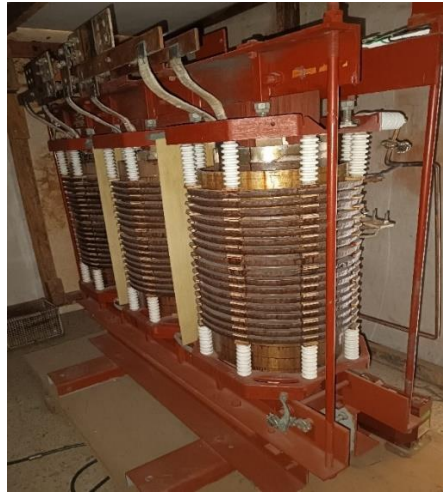
Ilustración 16: Transformador Trifásico de Bobinas Expuestas, 13800/480 VAC, 750 KVA, Conexión Dd0, en Plataforma de Descarga de C.H. 15 de Septiembre.
