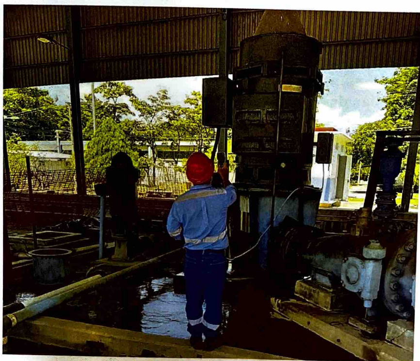
Imagen 4. 12– Uso de cámara termografía en Planta Potabilizadora las Pavas (ANDA). Fuente:” Propia”.
