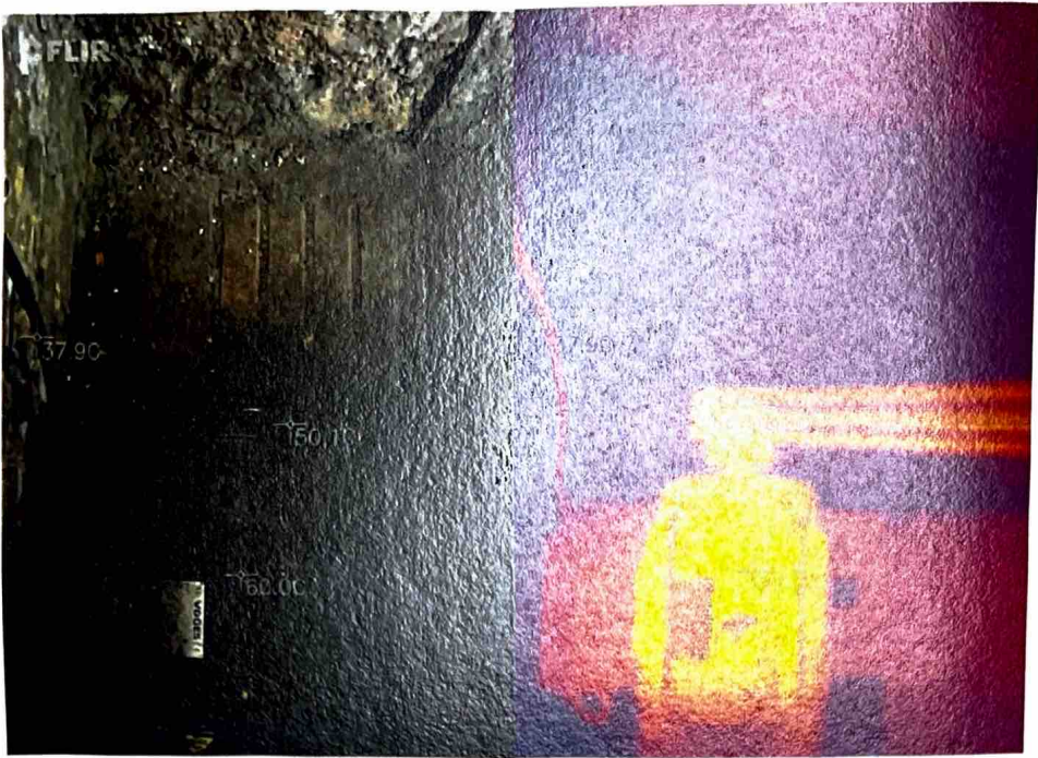
Imagen 4. 11–Imagen termográfica de motor en funcionamiento. Fuente: Propia.
