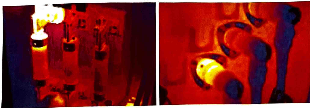
Imagen 3. 32– Conexión recalentada. Fuente: FLIR. Guía de termografía para mantenimiento predictivo.
