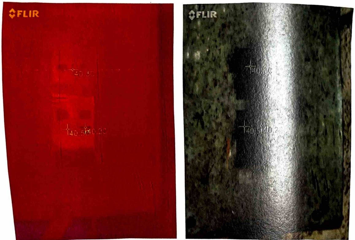
Imagen 4. 9 – Imagen termográfica, y fotografía normal de tablero. Fuente: Propia
