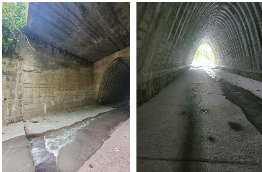
Figura 3.2 Bóveda hidráulica bajo 79 Av. Sur en Quebrada La Mascota. Fuente: Estefany Cárcamo 2024.
