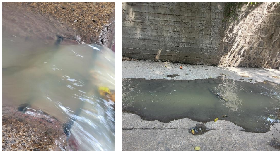
Figura 3.5 Acero expuesto debido a socavación local en salida de la Bóveda hidráulica bajo 79 Av. Sur en Quebrada La Mascota. Fuente: Estefany Cárcamo 2024.
