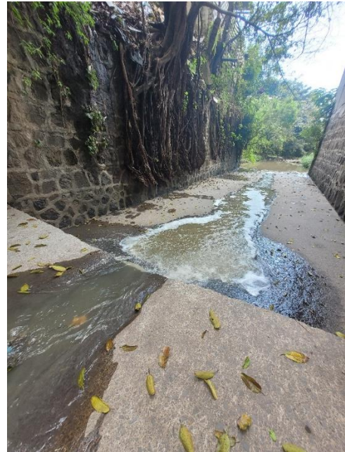
6- Fotografía de aguas abajo de bóveda 79 Av. Sur. Descarga de flujo.
