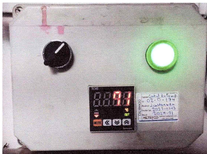
Imagen 1, Control de temperatura de Loop actual en sistema de tratamiento de agua no esteril
