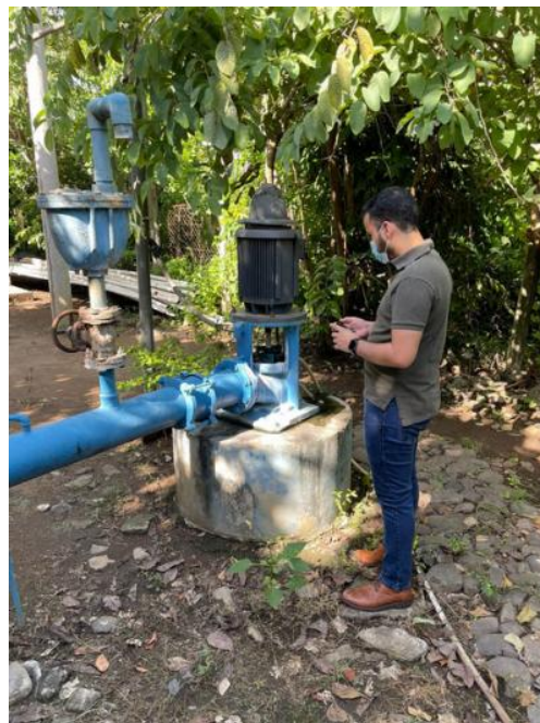
Imagen 4: Ubicación actual de tubería de succión en pozo
