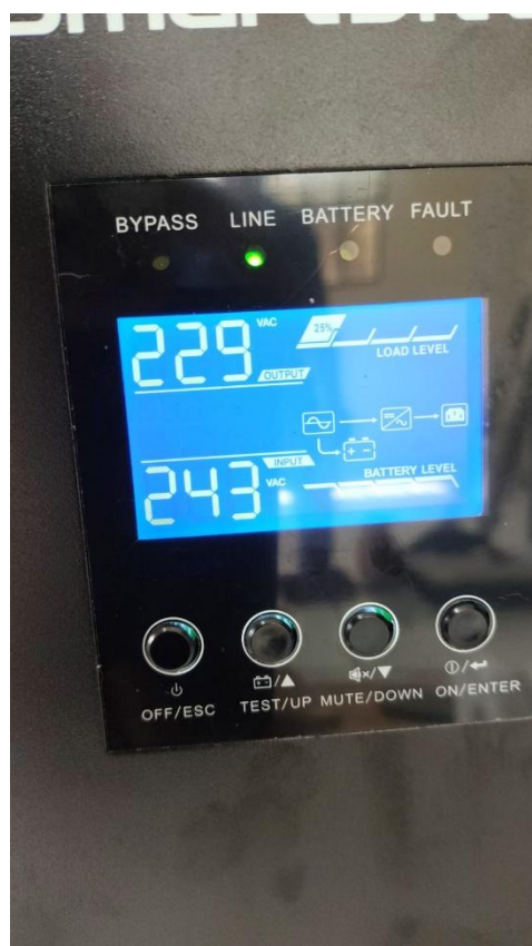
Figura 90. Salida de UPS (output) regulado a 230 +/- voltios.
