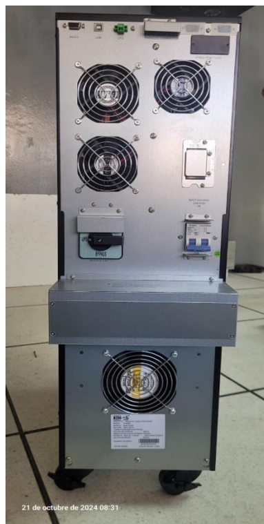
Figura 91. Parte trasera de UPS, bypass e interruptor termomagnético.
