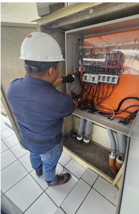
Figura 83. Mediciones de voltaje y resistencia de tierra.
