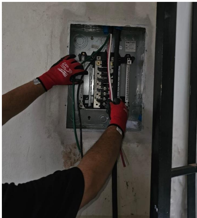
Figura 77. Conexión del subtablero para la alimentación del UPS.
