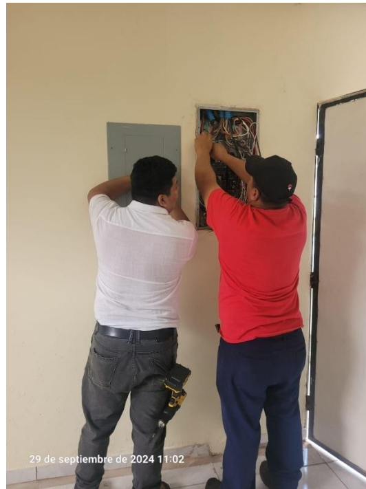
Figura 79. Conexión de entrada de UPS.
