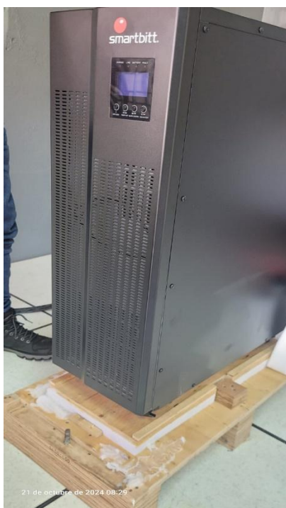
Figura 92. Parte delantera del UPS, entrada de aire y pantalla de control y configuración.
