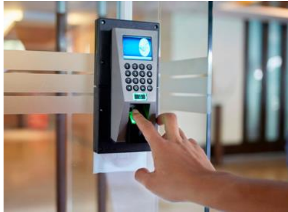
Figura 7.18. Sistema de control de acceso.
