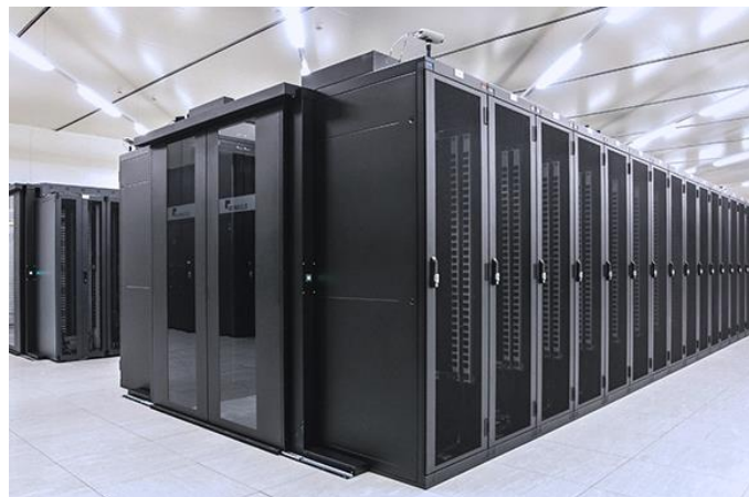
Figura 4.5 Distribución de gabinetes en un Centro de Datos.
