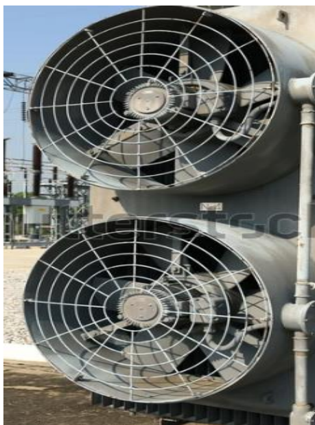
Figura 13. Sistema de refrigeración por medio del transformador. 13
