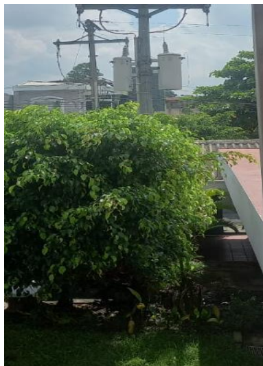
Figura 40. Visualización de terreno para realizar pruebas eléctricas a los transformadores en poste. 64
