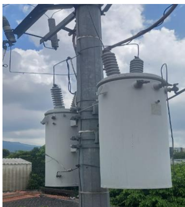
Figura 41. Visualización de transformadores monofásicos instalados en poste.
