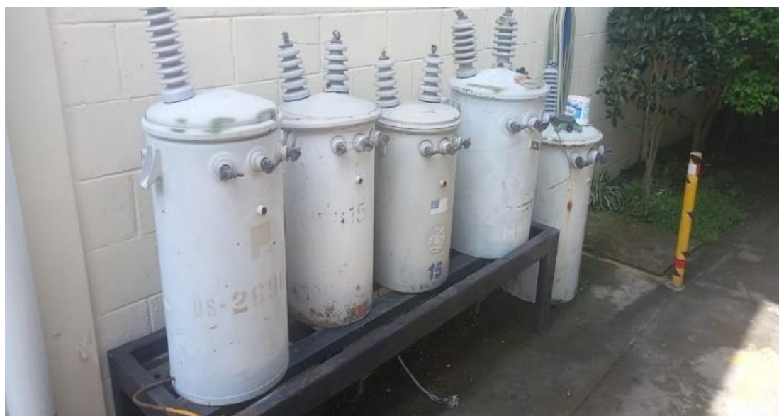
Figura 39. Visualización de transformadores monofásicos a nivel de piso sin aceite 63 .
