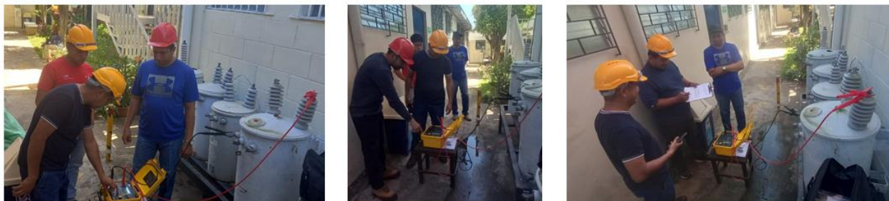
Figura 64. Muestra de pruebas eléctricas de resistencia de aislamiento en transformadores monofásicos clase C sin aceite al mismo nivel de piso 112
