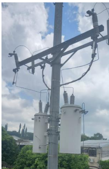
Figura 42. Visualización de estructura con SX100, cortacircuitos o fusibles en condición abiertos 66 .
