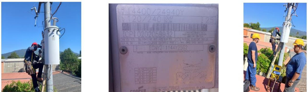
Figura 54. Toma de datos de placa y armado de configuraciones de conexión con cables de alta y baja de instrumento de medición. 90
