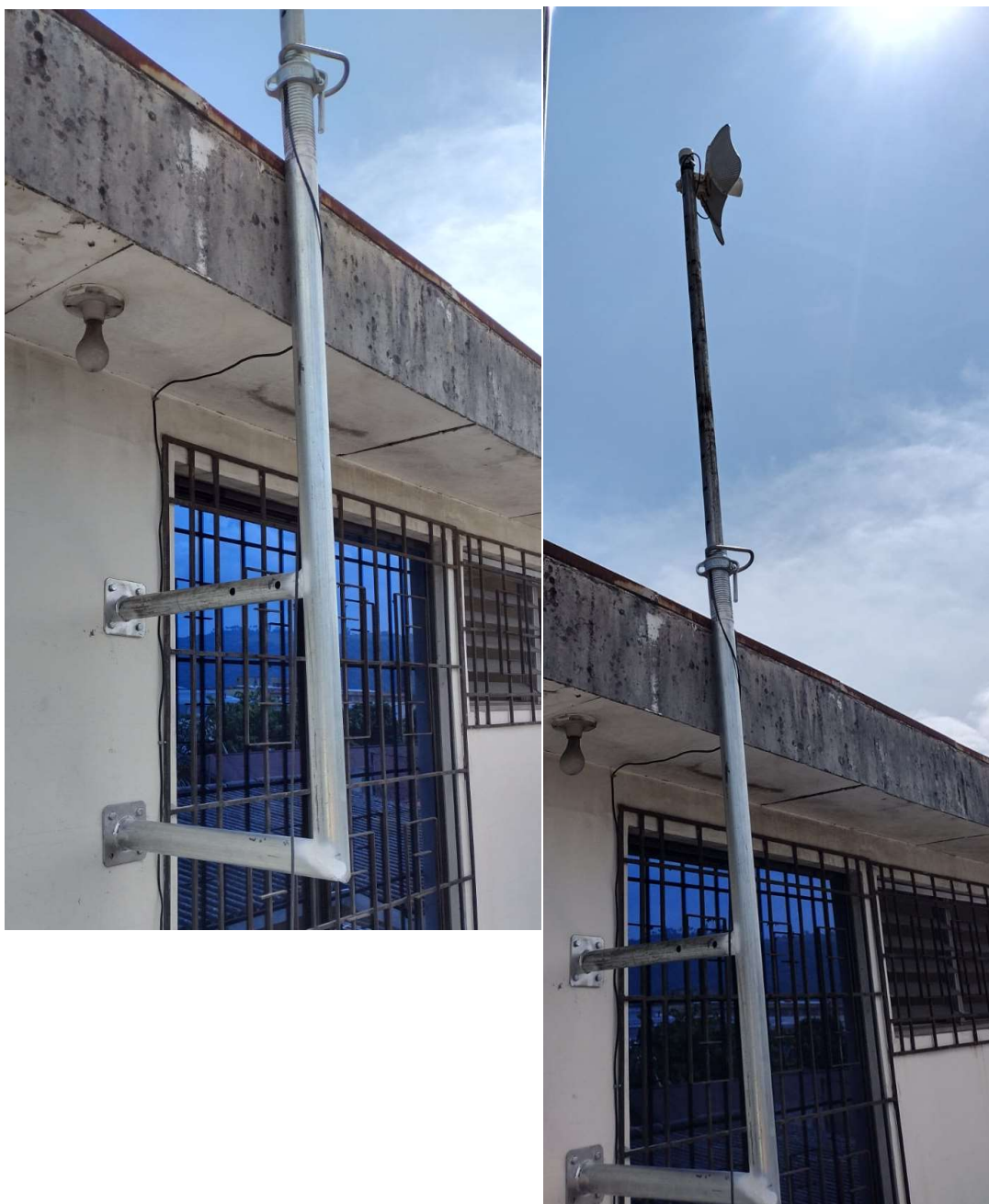
Fotografía 15 Estructura de antena sectorial
