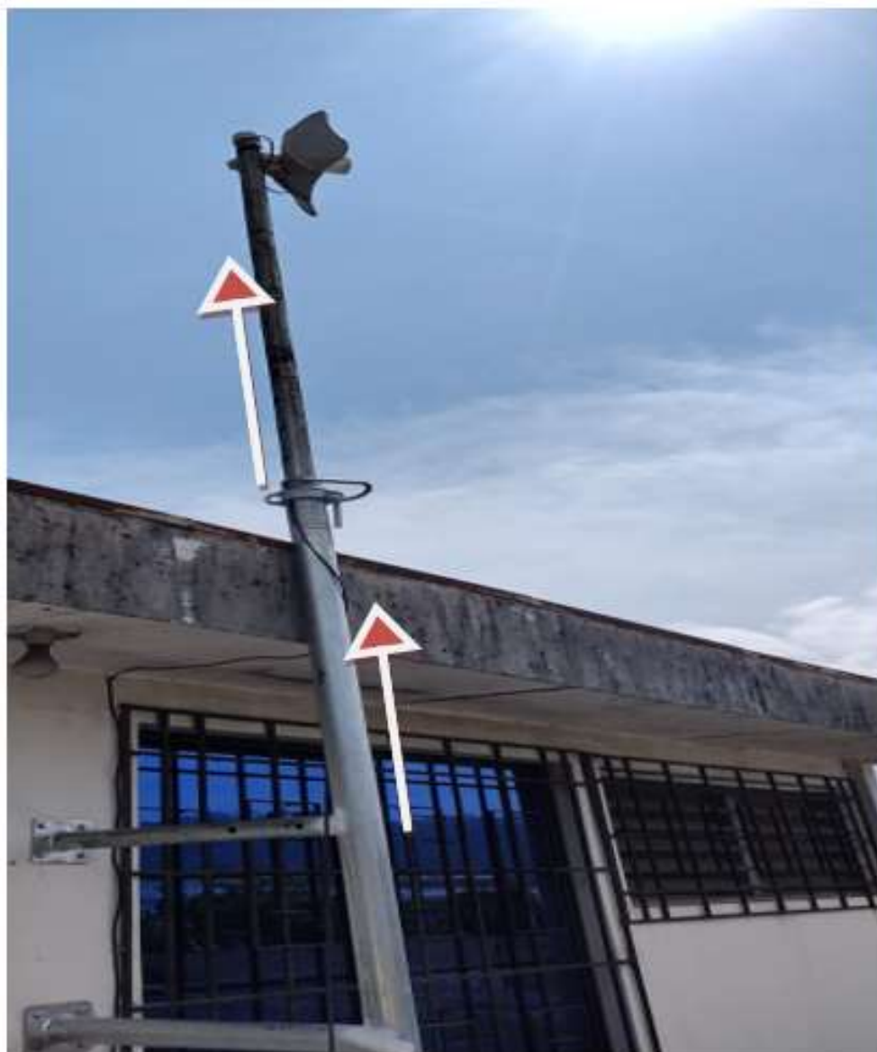
Imagen 52 Estructura del edificio H, sosteniendo la antena sectorial.
