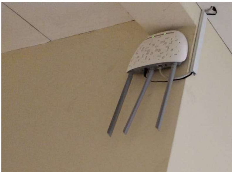
Imagen 58 Prueba del servicio de internet excelente en el edificio H.
