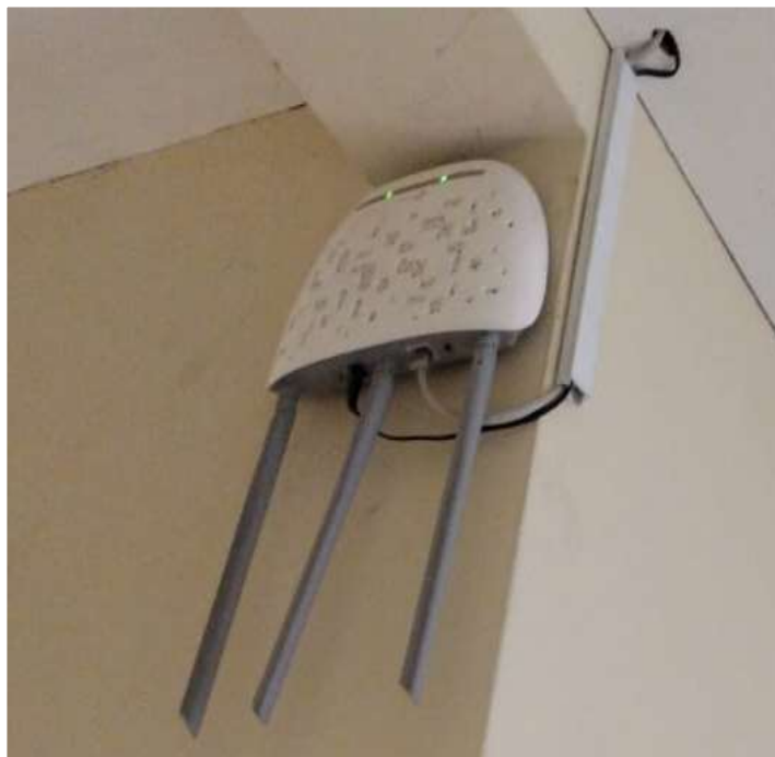
Imagen 54 AP para replicar el servicio de internet del edificio H
