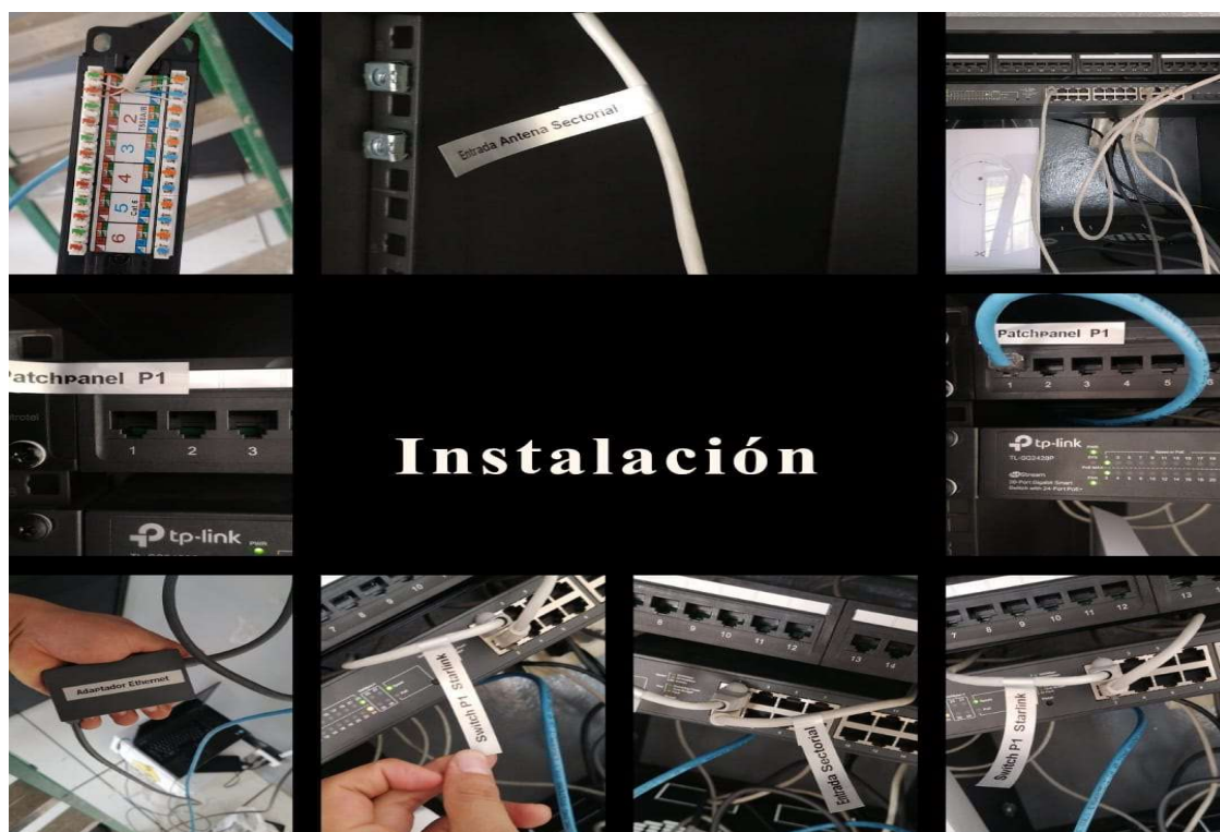
Imagen 60 Ordenamiento e identificación y viñetado red en gabinete
