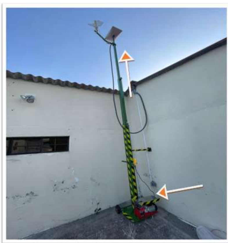
Imagen 48 Estructura de antenas en edificio F
