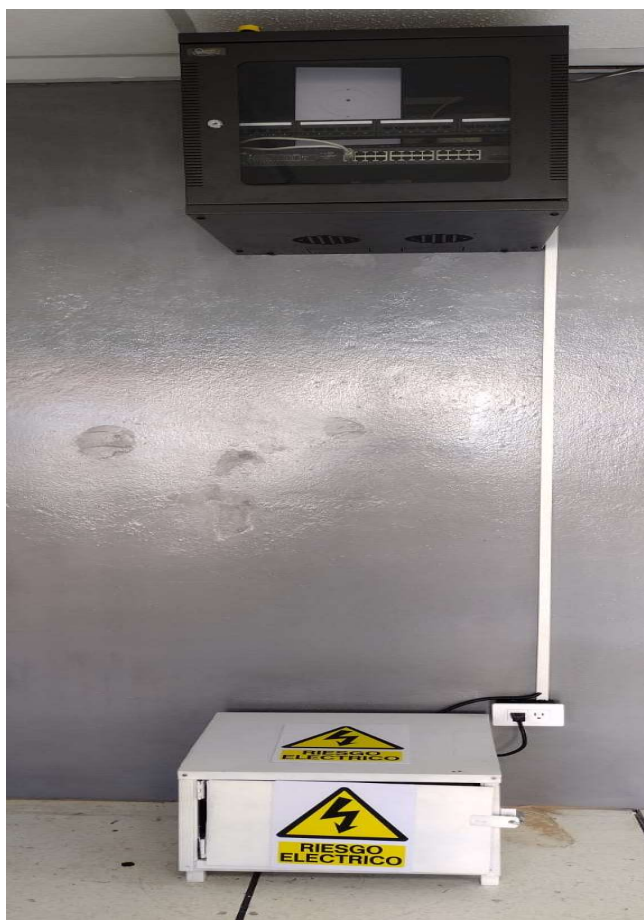
Fotografía 14 Gabinete de conectividad
