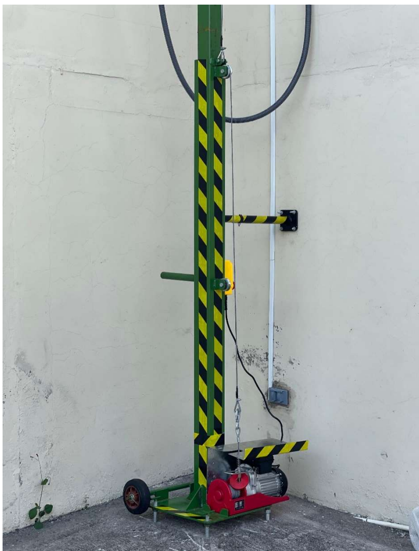
Fotografía 13 Base de estructura señalizada
