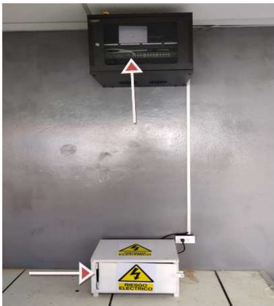
Imagen 50 Switch instalado y su equipo de respaldo
