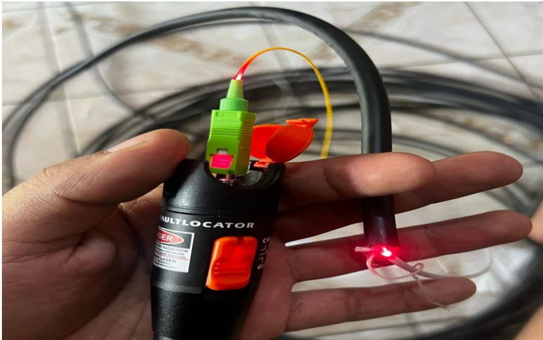
Figura 169. curvatura en el cable de fibra óptica.
