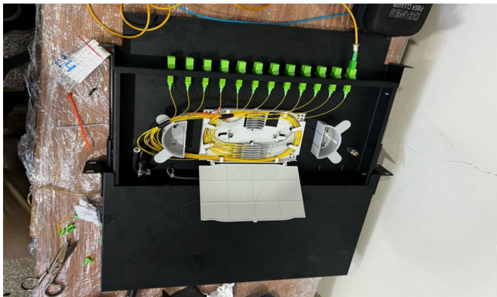
Figura 155. ordenamiento de cables de fibra óptica en ODF con la norma TIA 598C
