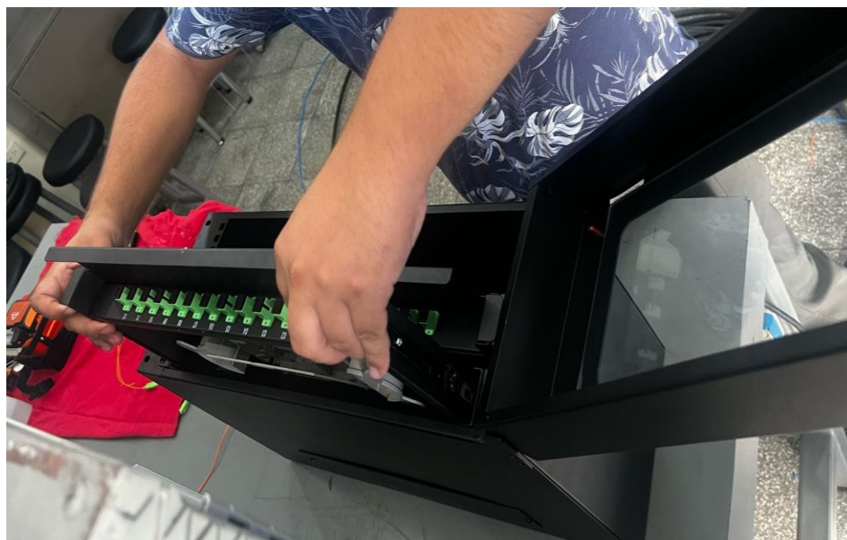
Figura 153. colocación de los ODF en el gabinete.
