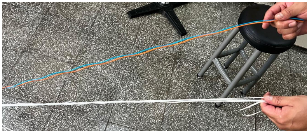
Figura 136. Separación de cables de fibra con viajeros.
