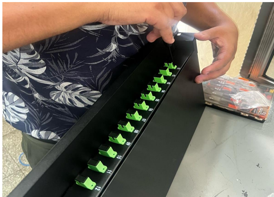
Figura 152. colocación de acopladores SC/APC en ODF.
