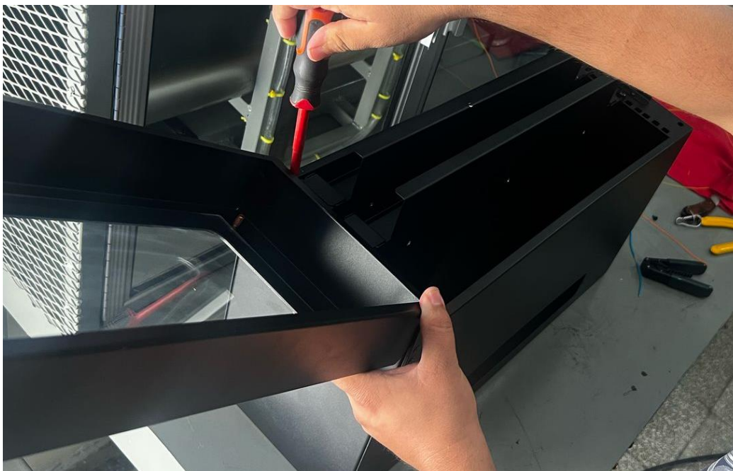
Figura 154. sujeción de ODF en gabinete.
