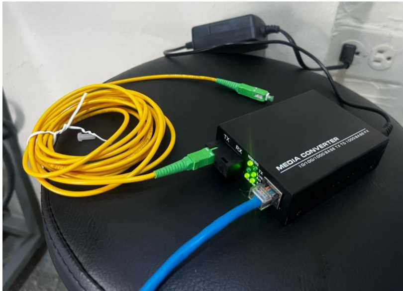
Figura 159. Módulo convertidor conectado a ethernet y fibra óptica.
