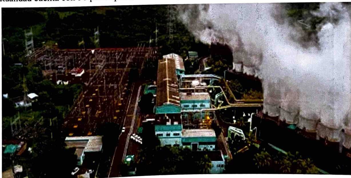
Imagen 47: Central Geotérmica Ahuachapán
