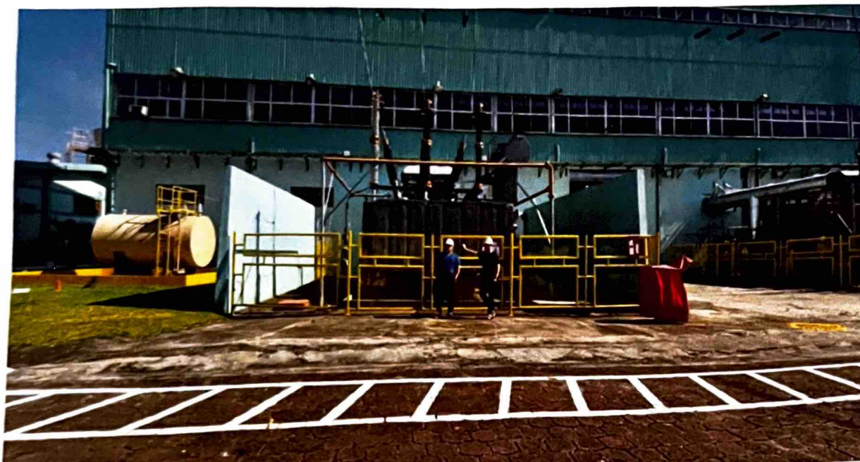
Anexo 16: Transformador reductor de 13.8 KV a 4.16 KV.
