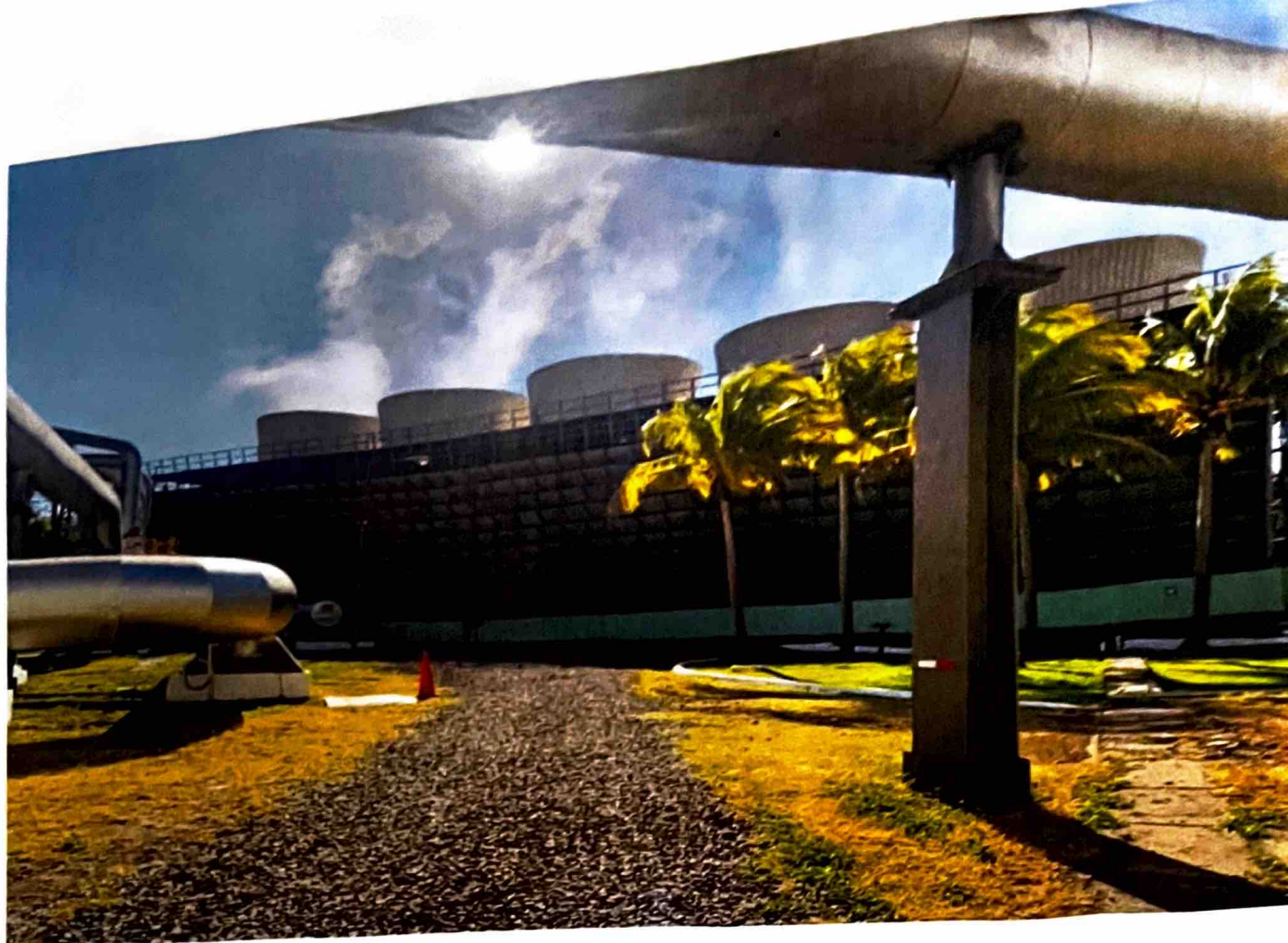
Anexo 14: Torre de enfriamiento de condensado.
