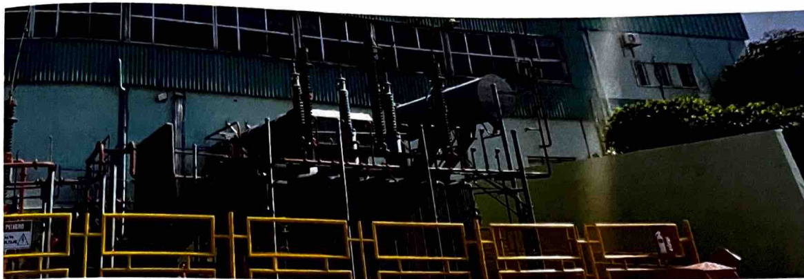
Imagen 92: Transformador elevador unidad 1 de Ahuachapán.
