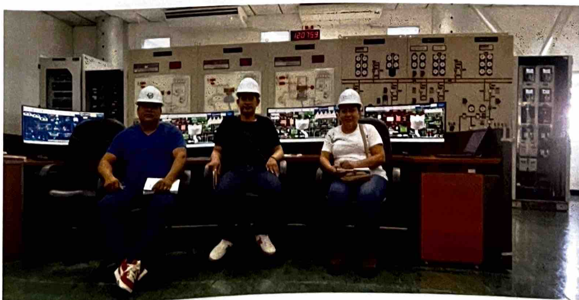
Anexo 20: Sala de control Ahuachapán.
