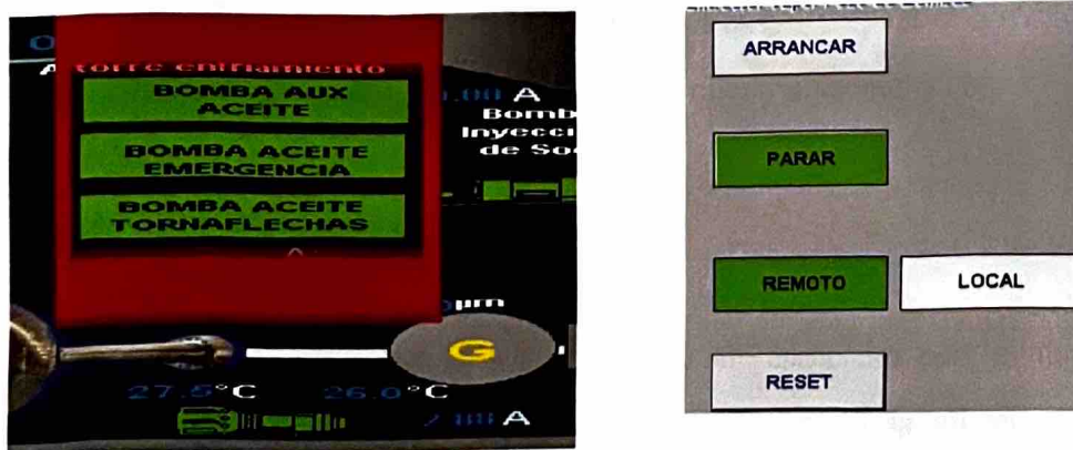
Imagen 109: bombas de aceite y sus botones de arranque y local remoto.
