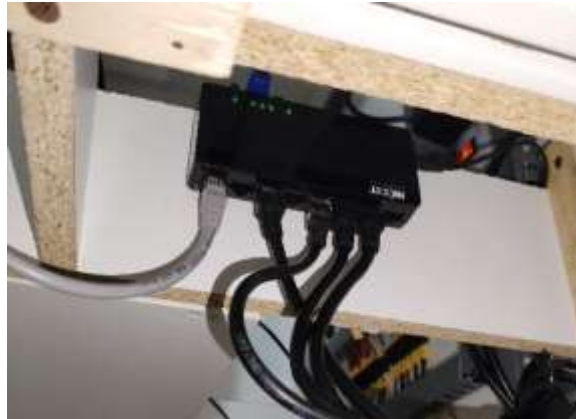
Ilustración 87 Switch de red conectado ordenado los cables ya no están expuestos
