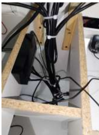
Ilustración 84 Switch hub para la conexión de los cables de red
